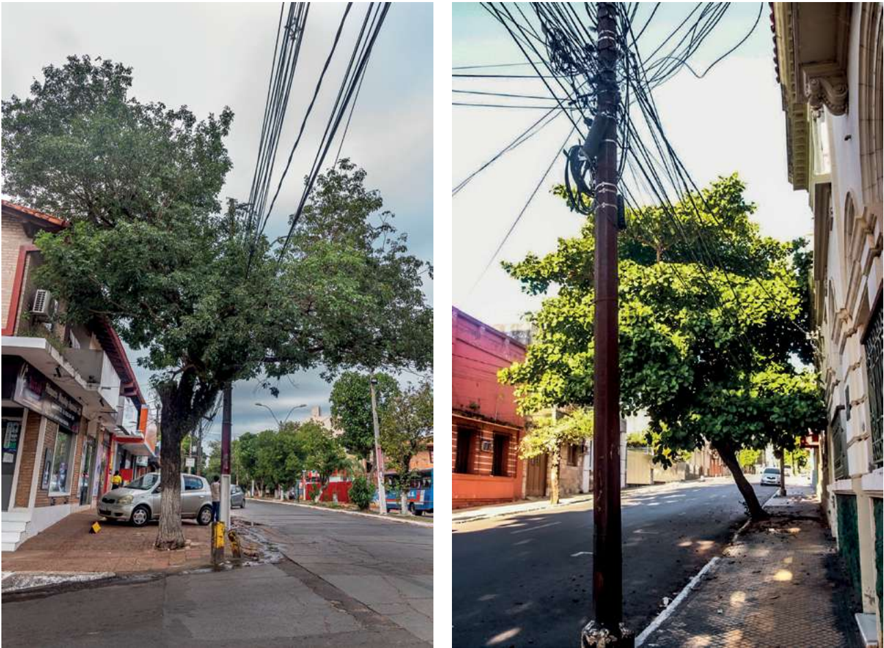
FIGURA 25: Árboles urbanos en conflicto con el tendido eléctrico
